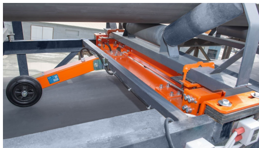
Установленный датчик скорости в составе конвейерных весов КЛИМ
